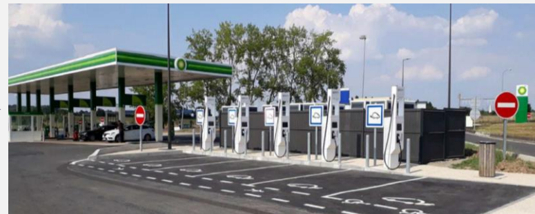
Fig. 2 : Exemple d'infrastructure de recharge pour véhicules électriques (IRVE) sur l'aire des Portes d'Angers (IONITY)
